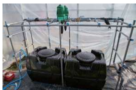
自動で液肥を作り施用する養液土耕栽培システム
